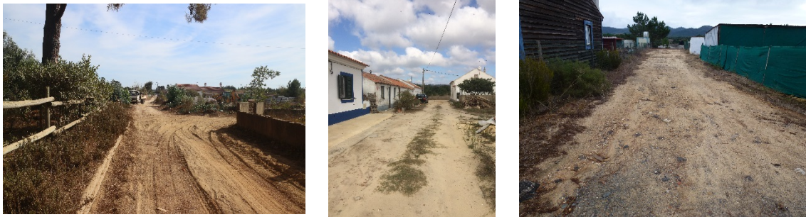
Figura 12: Exemplificação do mau estado de conservação das vias
